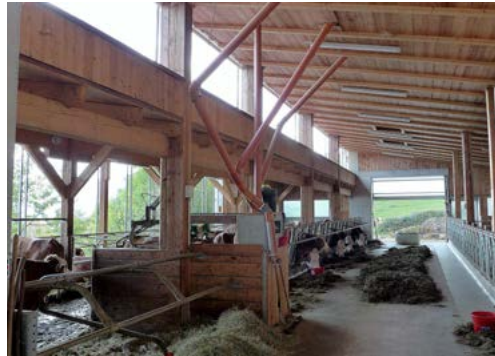
Firstentlüftung bei Zubau
