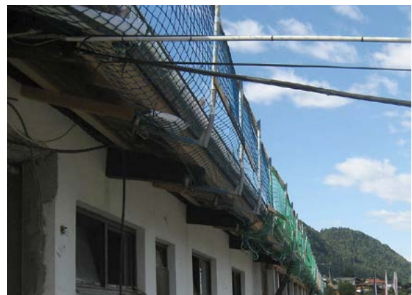
Dachfanggerüst mit Fußwehr (LK Tirol)
