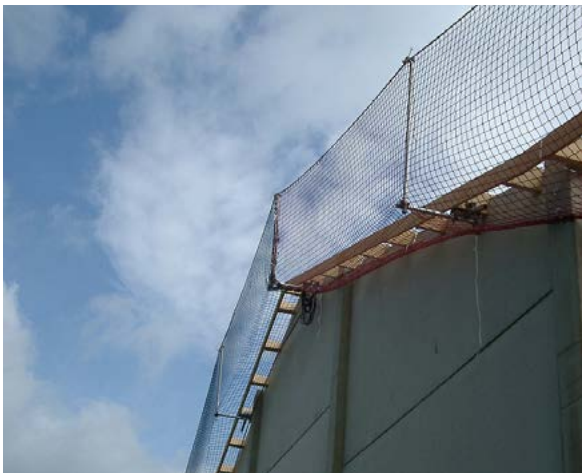
Fangnetz im Giebel- bzw. Ortgangbereich (LSV FOB)
