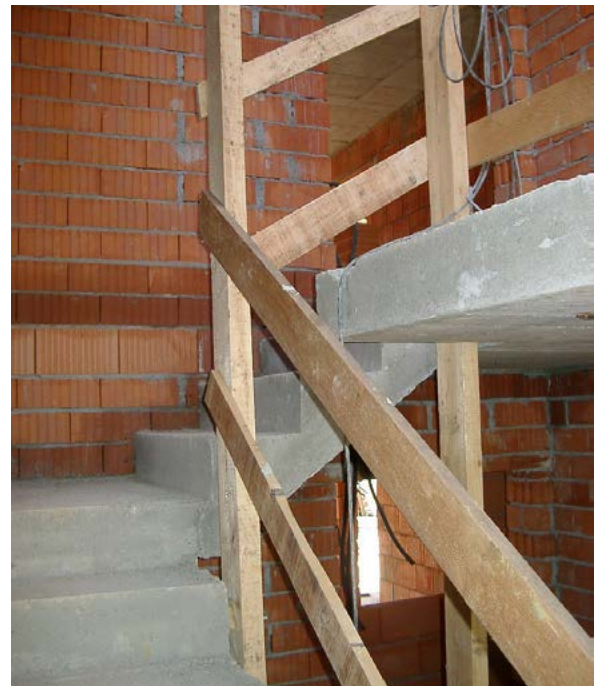
Provisorische Treppensicherungen (LSV FOB)
