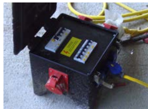
Verteiler (beide AUVA)
