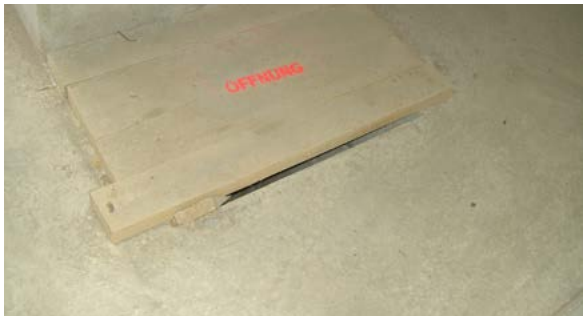
Abgedeckter Deckendurchbruch (AUVA)
